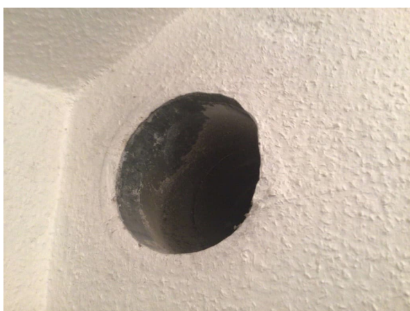
Doorvoeren uitgevoerd in metaal.
