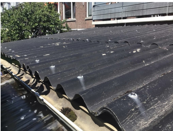
Het dak van de berging aan de Frederik Hendrikstraat 71 is inmiddels vervangen omdat deze beschadigd was, dit waren asbesthoudende golfplaten volgens de bewoners. Het is onbekend of de bergingen van de andere woningen nog asbesthoudende golfplaten hebben. De bergingen zijn uitsluitend bereikbaar via de woningen.
