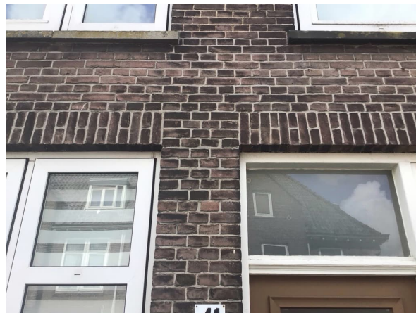
Steensmuren, geen spouwlaten aanwezig.
