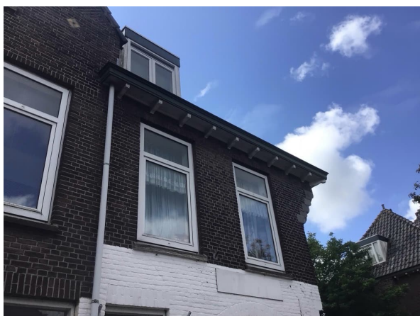
Goten bevatten mogelijk bitumen tussen zink en hout, dit valt buiten de scope van het visueel onderzoek.
