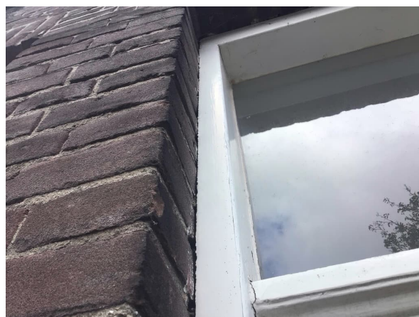
Houten gevelkozijnen bevatten geen neggekit.
