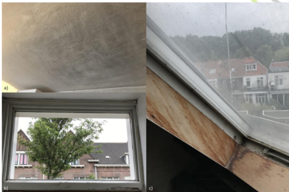
Figuur 6: Vochtschade (b) en bijkomende schimmel (a) en/of bladderend schilderwerk (c). Foto: Opdrachtgever.
