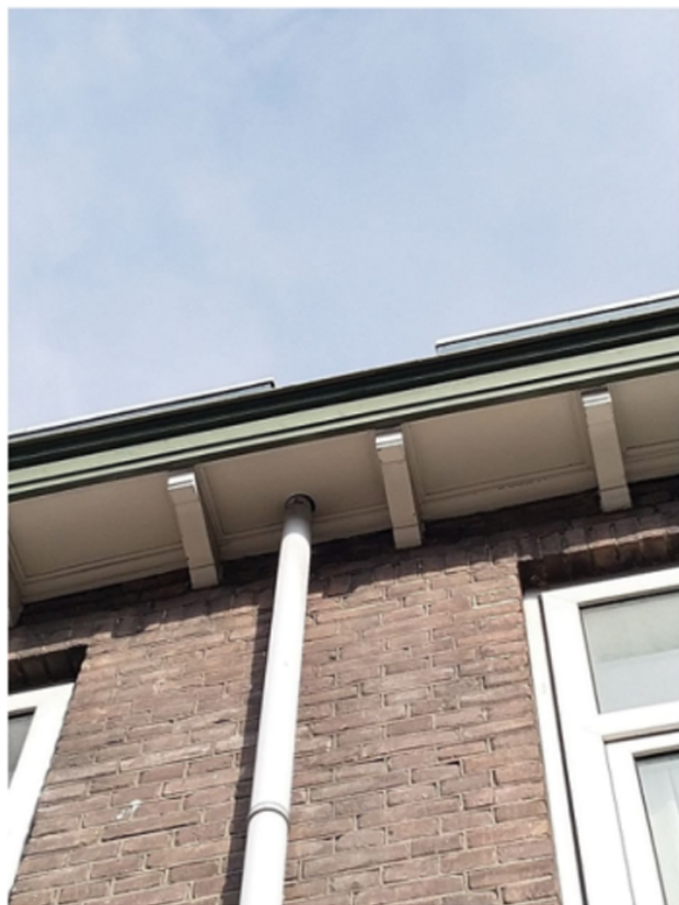
Tussen de buitenmuren en de houten bekisting van de dakgoot en tussen de regenpijp en de bekisting van de dakgoot bevinden zich smalle kieren. Foto: [redacted] Ecoresult B.V.
